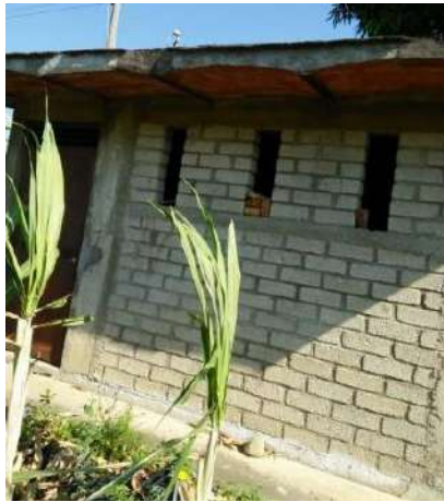
Fuente: Dirección de Agua Potable, Drenaje y Alcantarillado Instalaciones del pozo de agua, agencia Coamecatila
