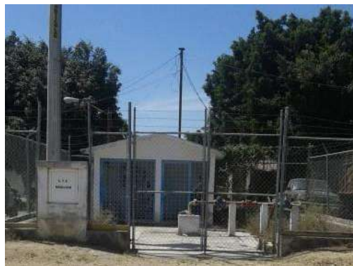
Fuente: Dirección de Agua Potable, Drenaje y Alcantarillado Instalaciones del pozo de agua, agencia El Coahuayote
