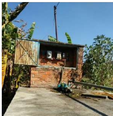
Fuente: Dirección de Agua Potable, Drenaje y Alcantarillado Instalaciones del pozo de agua, agencia el Mastranzo
