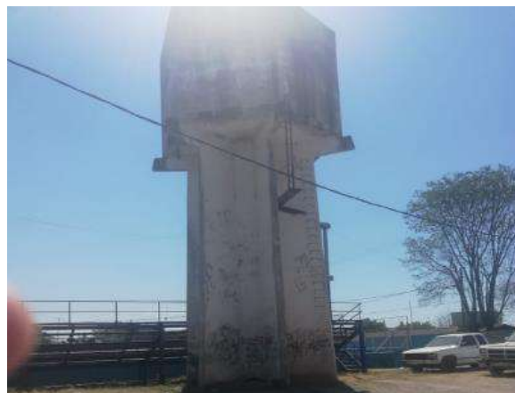
Fuente: Dirección de Agua Potable, Drenaje y Alcantarillado Instalaciones del pozo de agua delegación El Rincón
