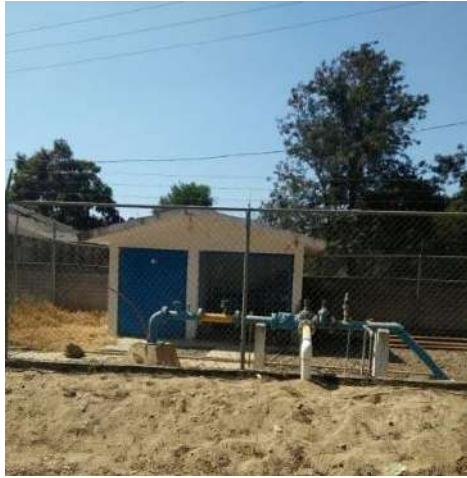
Fuente: Dirección de Agua Potable, Drenaje y Alcantarillado Instalaciones del pozo de agua delegación de Tasinaxtla
