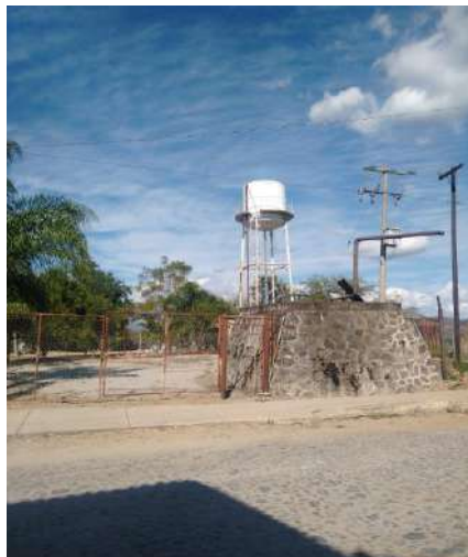
Fuente: Dirección de Agua Potable, Drenaje y Alcantarillado Instalaciones del pozo de agua, agencia San José de la Tinaja
