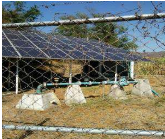
Fuente: Dirección de Agua Potable, Drenaje y Alcantarillado Instalaciones del pozo de agua delegación El Aserradero
