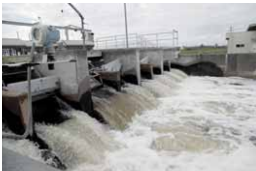
Planta de tratamiento.
